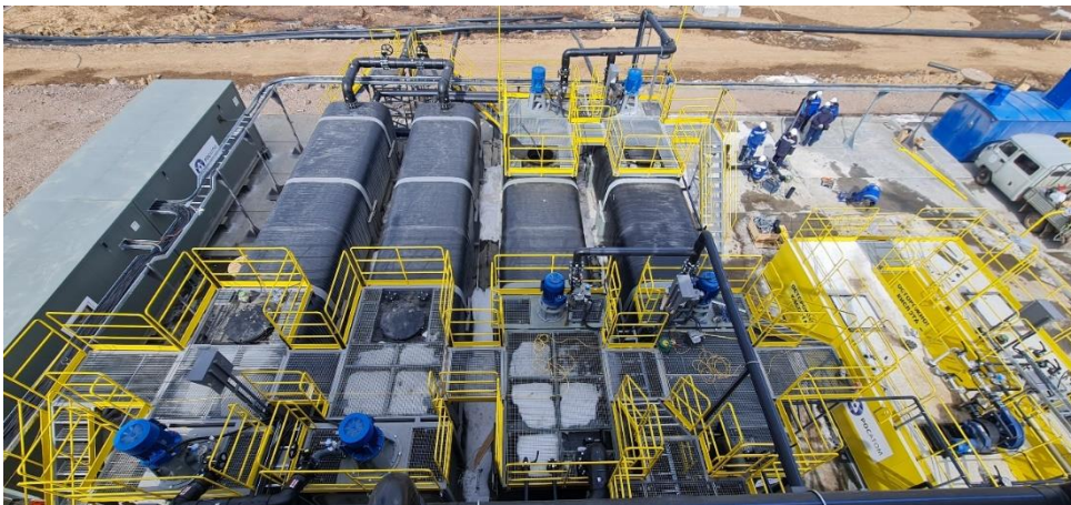
Локальная сорбционная установка (МСУ)
